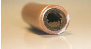
Versprödetes und verschlammtes Bodenheizungsrohr.
