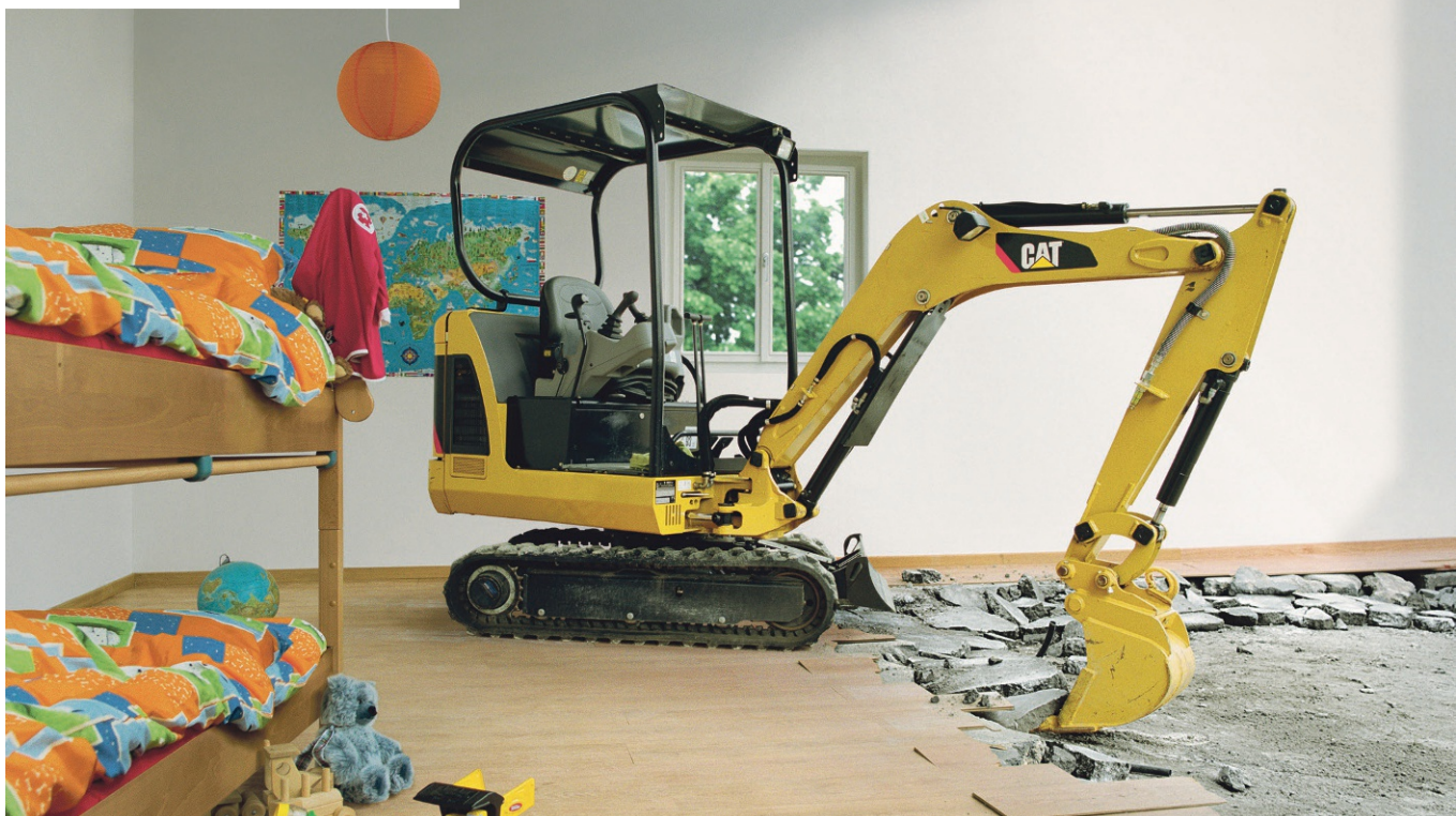
Grâce au HAT-System, vous pouvez éviter ce genre de chantier.
