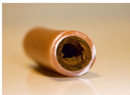
Conduite de chauffage au sol fragilisée et encrassée.
