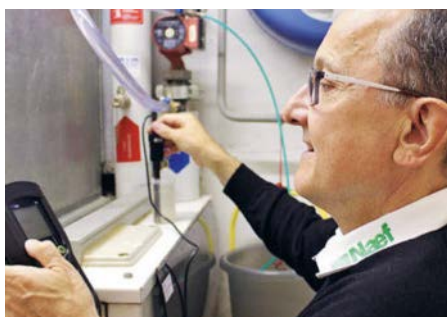
Instructif: contrôle complet du chauffage au sol par le Naef Group.
